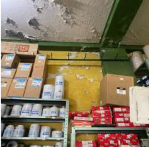
Humedad dentro del Almacén
